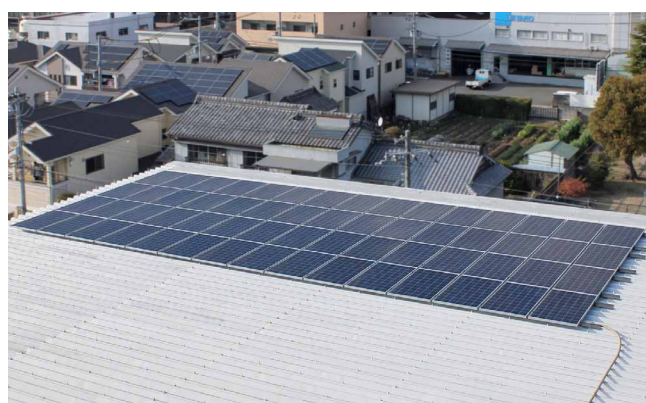
第二物流センターの屋上2カ所に太陽光発電システムを設置
