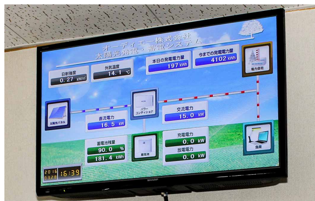
事務所内にもモニターを設置され発電・蓄電状況を確認
