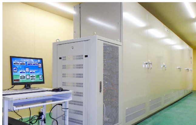
蓄電池設備室には、制御サーバー、蓄電池、ハイブリッドパワーコンディショナが並ぶ
