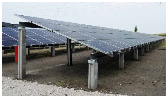
パネル設置角度は20度、落雪を考慮して地面からの高さは約1,100mm
