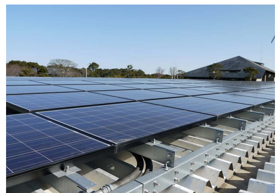
駐車場屋根の架台にしっかりと敷き詰められた太陽光モジュール
