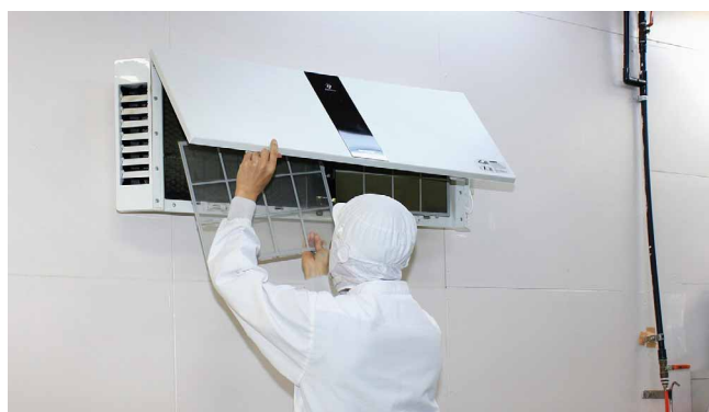
壁掛け設置は、作業スペースが広く使えるだけでなく、フィルター掃除などメンテナンスがしやすい点もメリット
