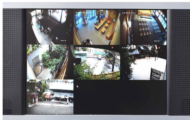
境内全体の様子が、モニターで一目で見て取れる
