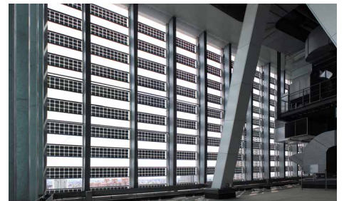
建材一体型ソーラー (15F 機械室内部から)
