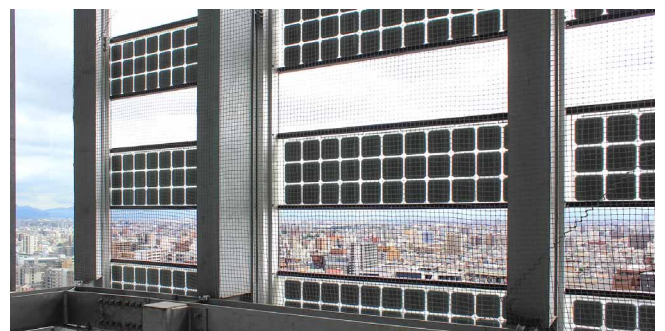
15Fの機械室内部から望むクリスタルスルーソーラー
