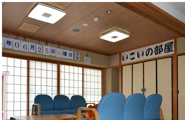
共用スペースの和室には、雰囲気に合わせて木目調のシーリングライトを設置
